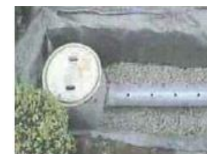
浸透トレンチ
