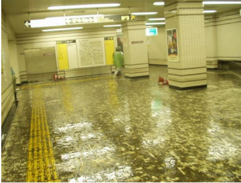
平成 16 年 10 月 9 日台風 22 号による地下鉄南北線麻布十番駅 コンコース広場の浸水後の状況
