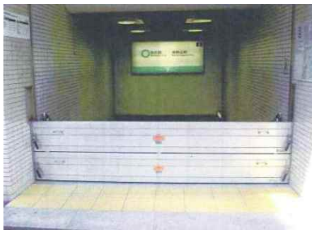
写真 7-3 止水板による地下浸水対策の例
