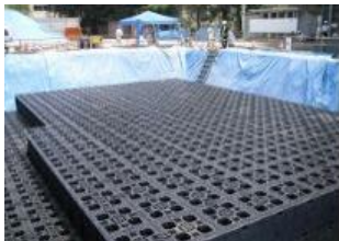
一次貯留施設（校庭貯留）
