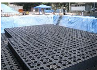
一次貯留施設（校庭貯留）
