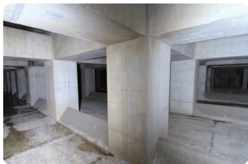
みなみすなうすいしょうせいち こうとう く 南砂雨水調整池(江東区)
